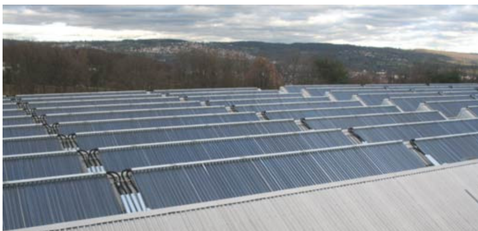
Photo: Paradigma Energie- und Umwelttechnik GmbH & Co. KG.
