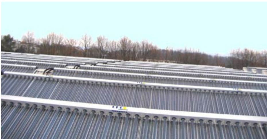
Photo: Paradigma Energie- und Umwelttechnik GmbH & Co. KG
