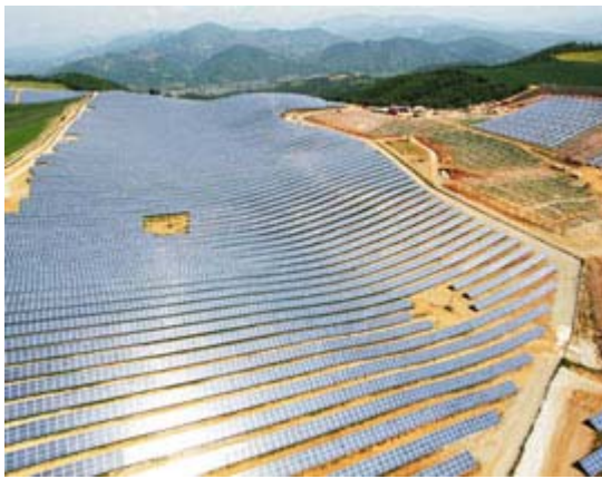
The Les Mees PV plant
